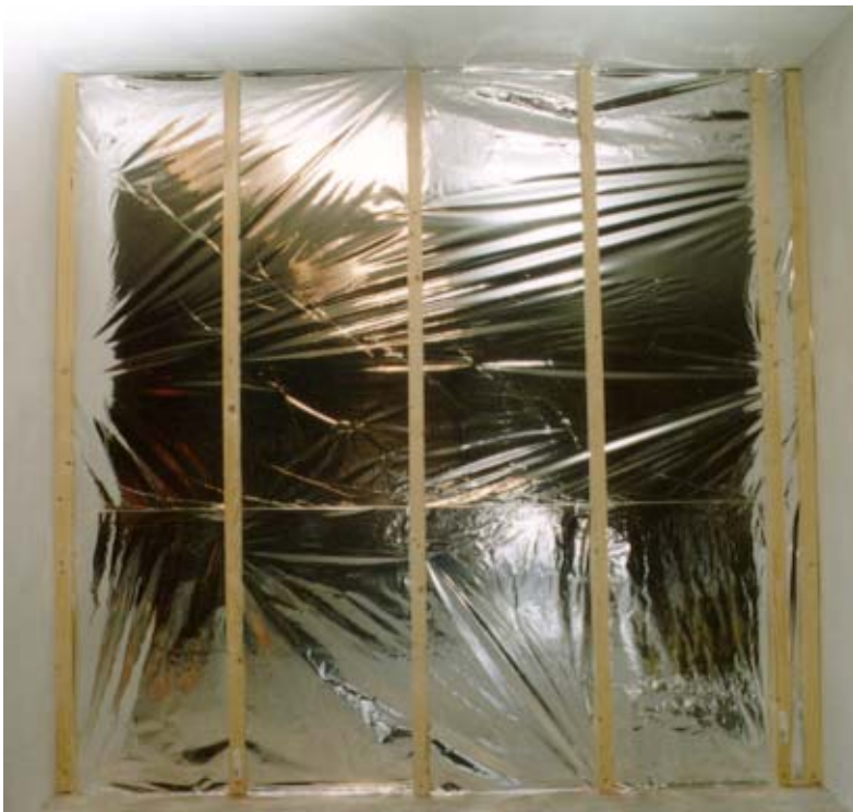
Afbeelding 1: Een met Thermosheets geïsoleerde wand gereed om afgewerkt te worden met bijvoorbeeld gipsplaten .
