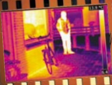
De radiator is niet afgeschermd. Veel warmte verdwijnt door de muur zoals deze infrarood foto laat zien.
